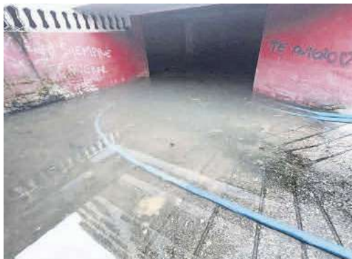
Garajes del edificio de la calle Noria 4, anegados de aguas turbias.
